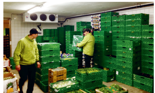
Frisches kommt und geht: Kühlraum der Firma Adank.
